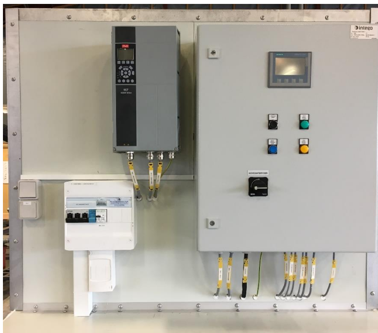
Figur 5: Eksempel på standardstation set fra el-siden
