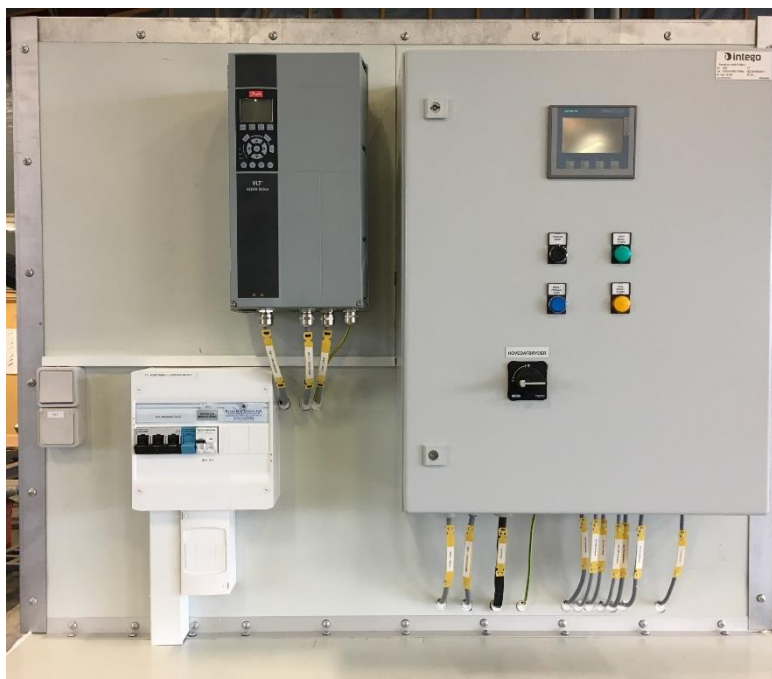
Figur 5: Eksempel på standardstation set fra el-siden
