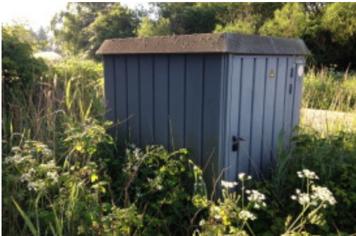
Beispiel einer Station mit großem, mechanischem Verschleiß des Anstrichs aufgrund von Bewuchs
